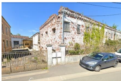
Figure 4.48 Exemple d'une friche située en enveloppe urbaine : ancienne fromagerie à Rouvroy-sur-Audry (parcelle : 5 360 m 2 / surface bâtie : 2 700 m 2 ) coûts de déconstruction estimés : 175 000 € (Google street view)
